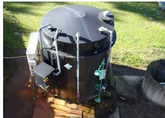
Unité de stockage et d'injection de chlorure ferrique (STEP SYDEC) Source : GEDEAU CONSEIL
