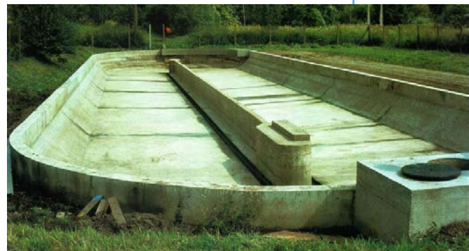
Photographie d'un bassin d'orage Source : FNDAE
